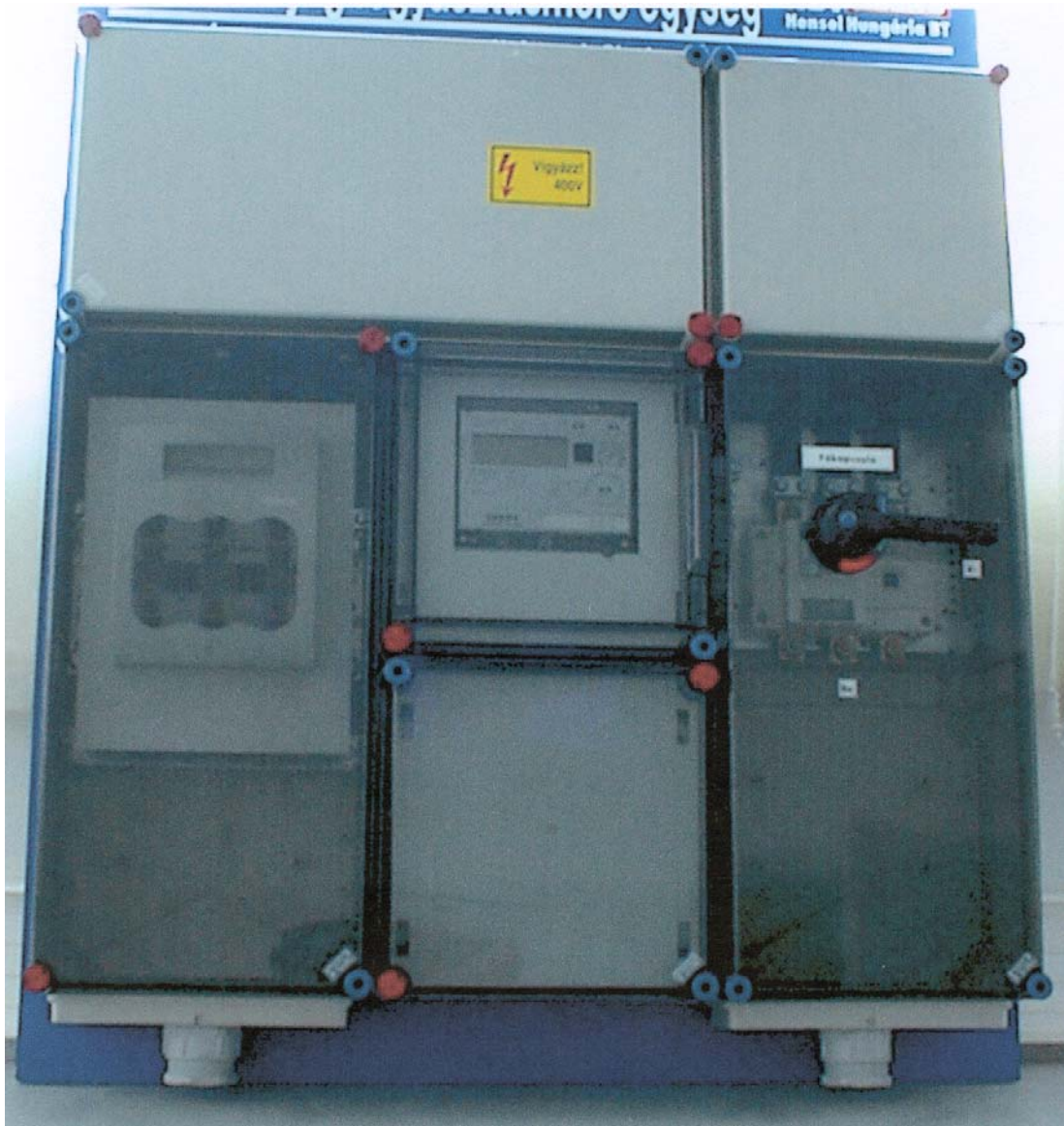
HÁFM - 250 típusú áramváltós mérőhely
