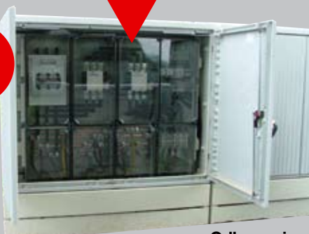
Odlączenie, pomiar, zabezpieczenie nadprądowe
